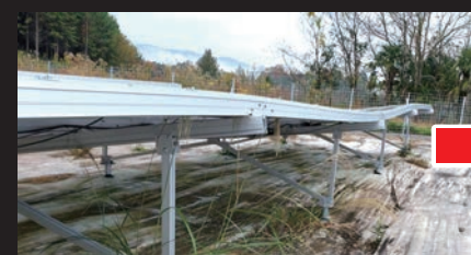
スクリー杭が沈下してレールの一部が 曲がっています。
